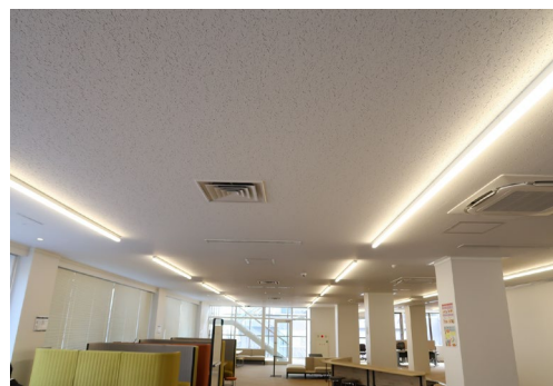
附属図書館 LED照明
