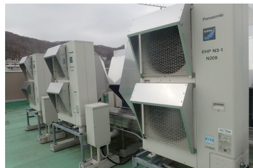
教育・研究3号館屋上 エアコン室外機
