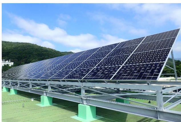
教育・研究1号館B棟屋上 太陽光発電設備
