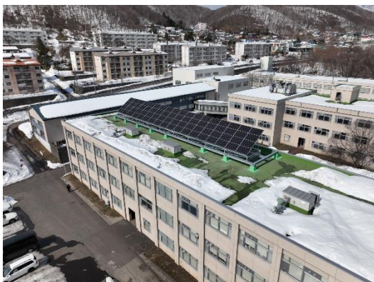
新たに設置した太陽光パネル
